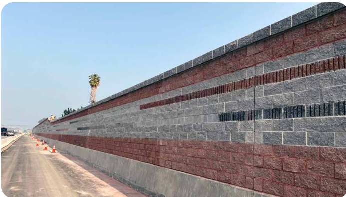
Sección completada de la pared de sonido en Bayshore Boulevard desde la avenida Dore hasta la avenida East Poplar en la ciudad de San Mateo.
